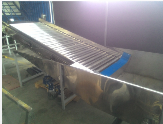
Tanque de imersão
