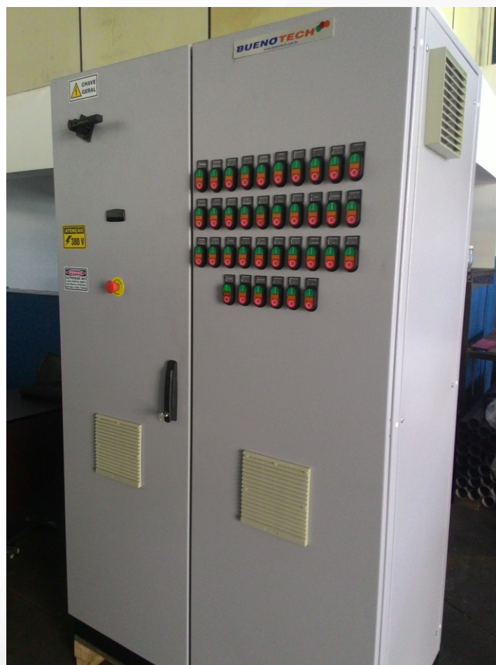
Painél de comando
